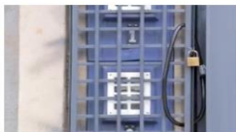
Polícia Civil realiza operação de combate ao furto de energia em Itararé — Foto: Reprodução/TV 13
